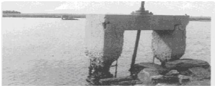
干湿循环区域破坏最为严重
