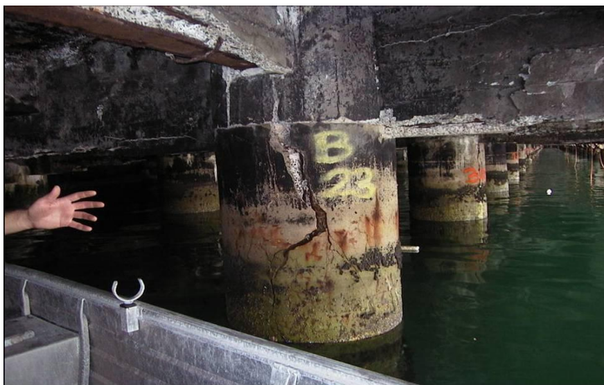
海水中氯盐侵蚀引起的结构破坏
